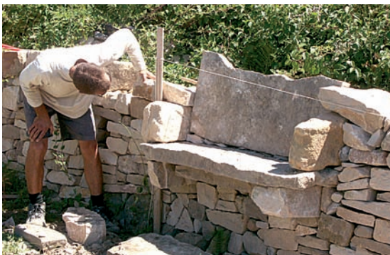
▲► Création d'un banc dans un mur en pierre sèche. Habillage des escaliers en pierre de Roquemaillère. Bel appareillage de pierres en calades, sur des terrasses.
